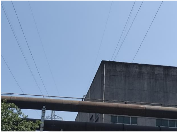
线路去往变电站方向
