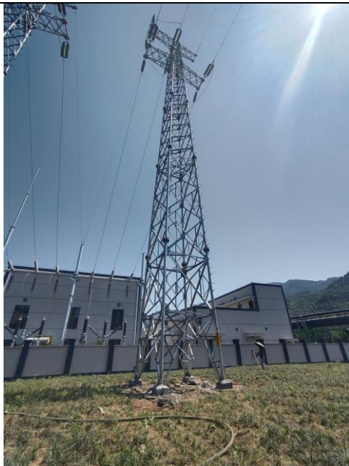
已建 110kV 魏顺线 J3 铁塔
