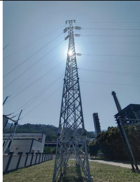
已建 110kV 沫曹线 G3 铁塔
